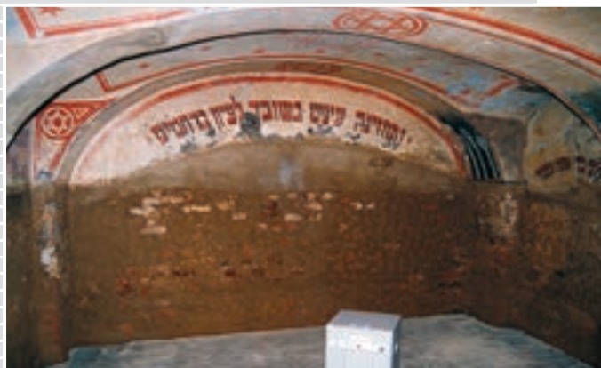
Povodeň 2002. Poškozená modlitebna z doby ghetta.
